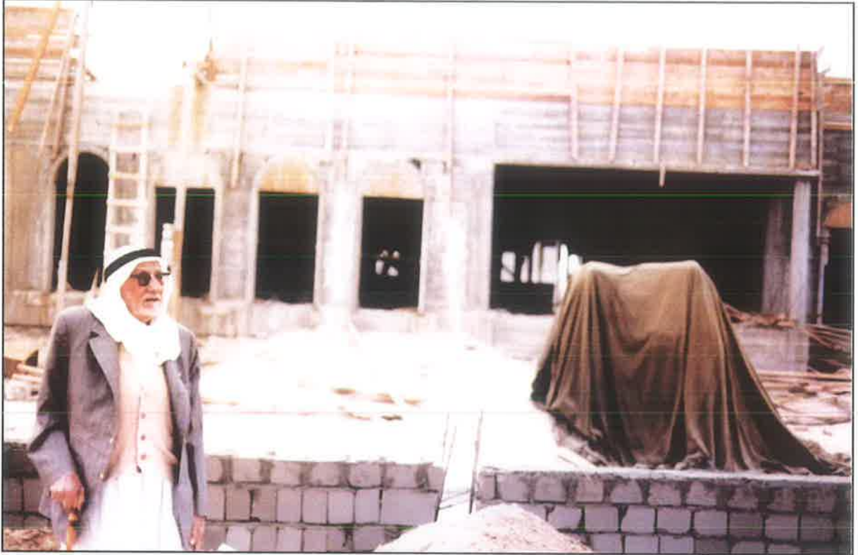
الحاج إسماعيل وهو يتابع عملية بناء منزلي في مشرف عام ١٩٧٩م في مراحل مختلفة
